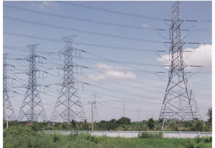
เสาไฟฟ้า
