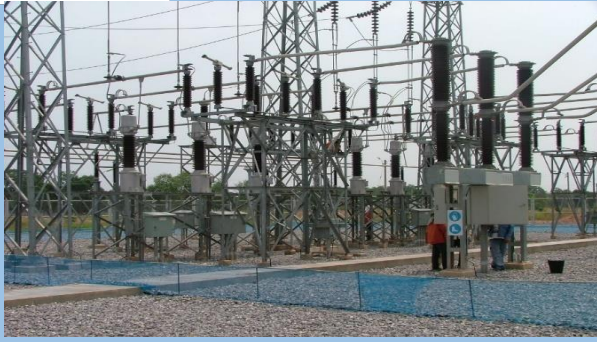
ลานไฟฟ้า
